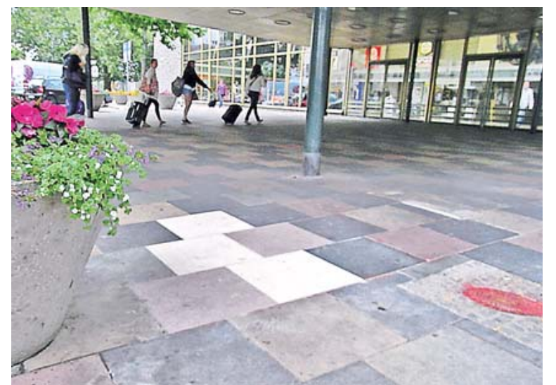
Nicht nur aus denkmalpflegerischer Sicht ist der Plattenbelag auf dem Vorplatz des Hauptbahnhofs kein Vorzeigestück mehr.
